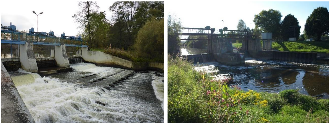
Abb. 23. Querbauwerk: Wehr mit Schützen
