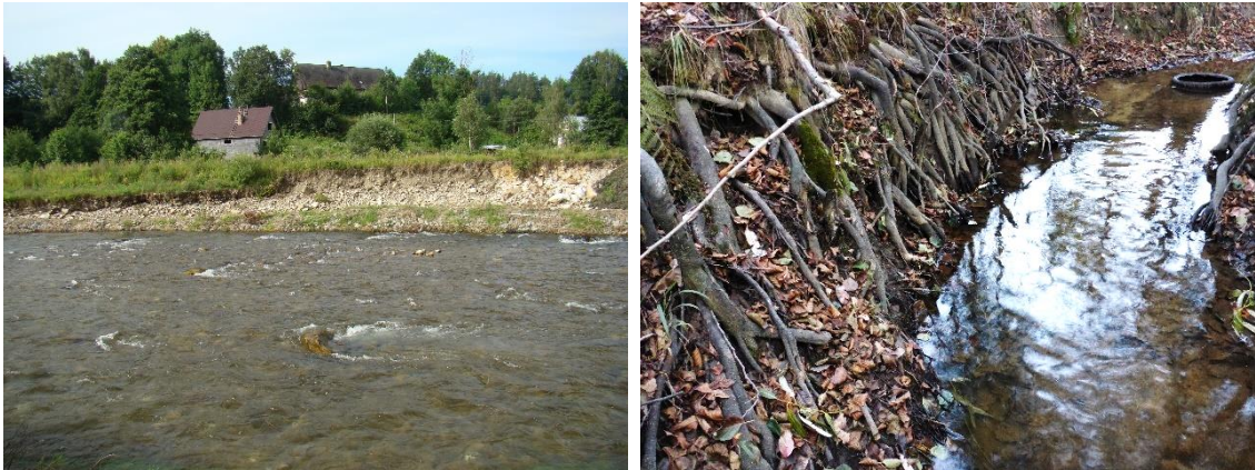
Abb. 16. Unterspültes Ufer (links), unterspültes Ufer (fixiert mit freiliegenden Baumwurzeln) (rechts)
